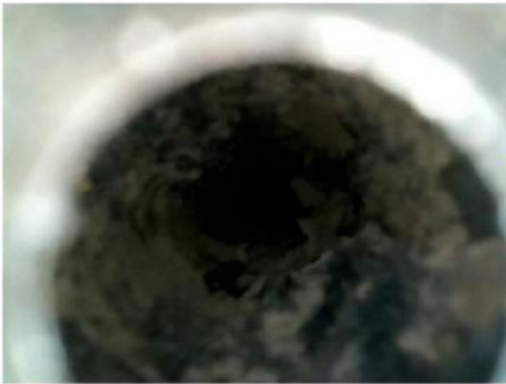
清洗前管道堵塞不透光
